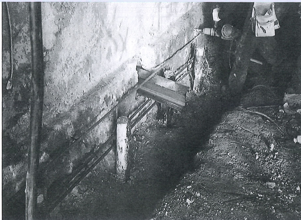
Foto n° 1 – Intervento di consolidamento delle fondazioni esistenti mediante fondazioni indirette micropali e putrelle a moncone
